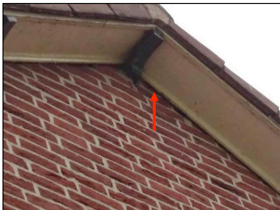
Foto 3: Spleten tussen muur en houtconstructie
